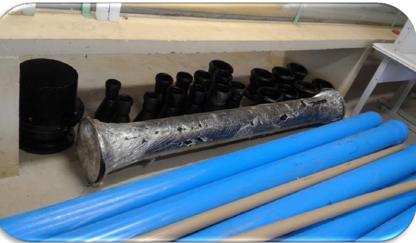
Figura VIII Material do sistema hidráulico para montar bancada - tubulação em ferro fundido.
